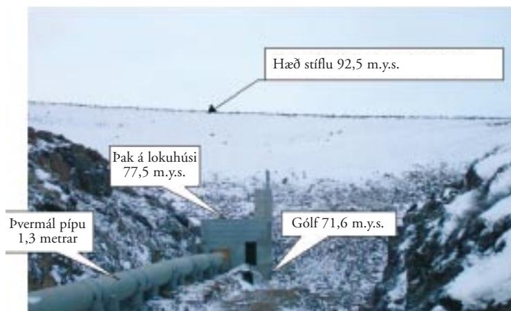
Nýja stíflan við Þverárvirkjun.
